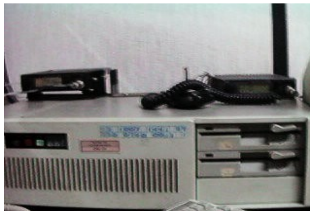
Gambar 1.1 Gateway/Router ITB Pertama (tahun 1993). Sumber: http://opensource.telkomspeedy.com/wiki
