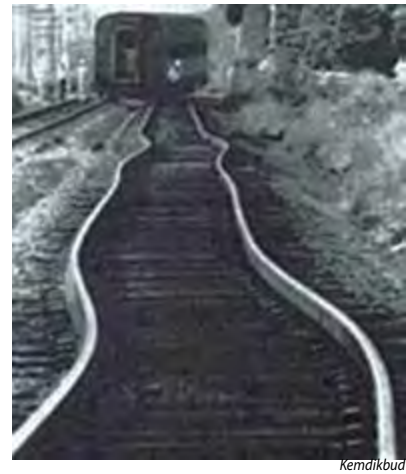
Gambar 7.14 Rel kereta api dapat melengkung akibat pemuaian
